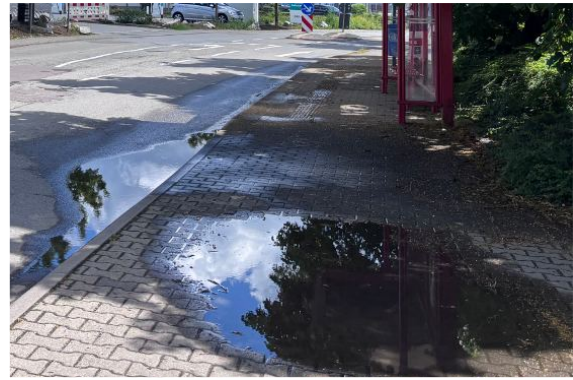
Beispielbild für Oberflächenschäden auf Gehwegen. Foto: Stadt Weinheim
